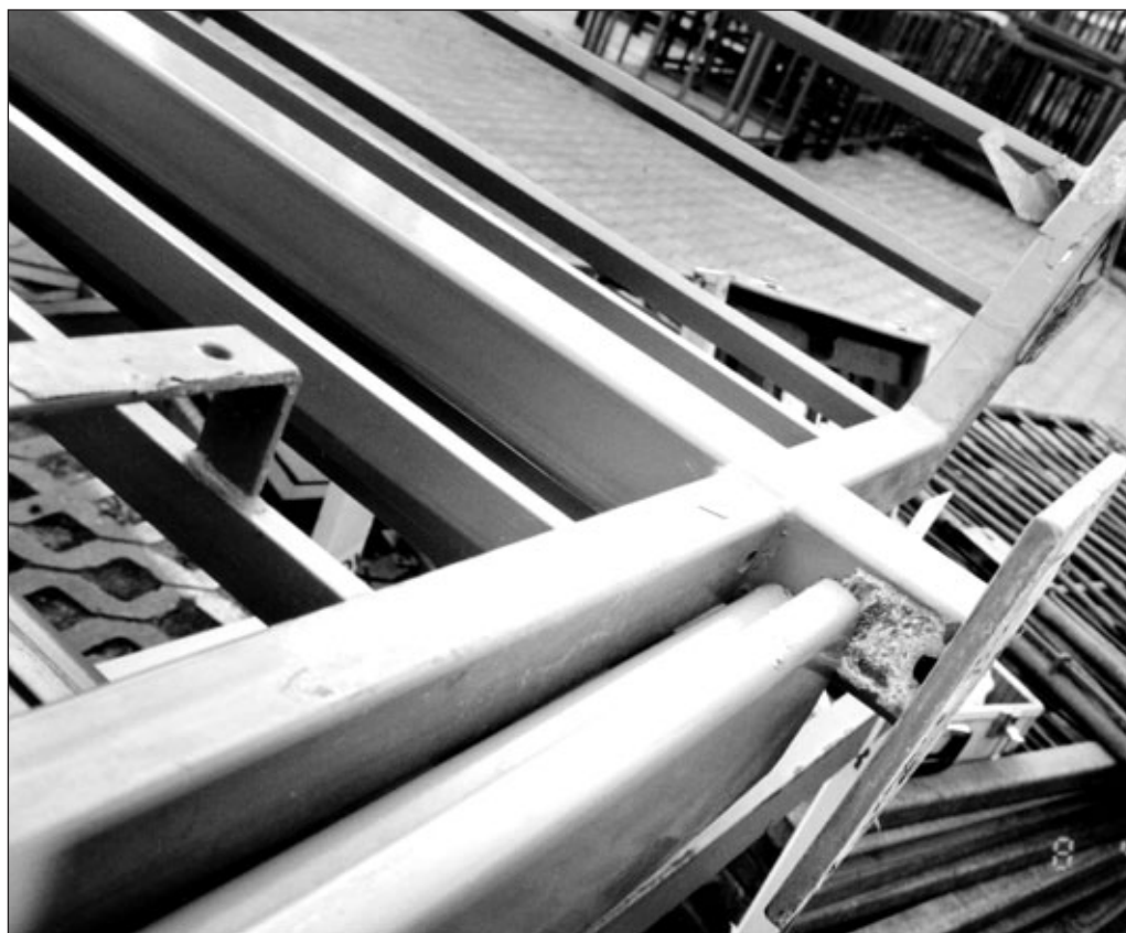
Aggressive Auftausalzbelastungen an einer Geländerkonstruktion nach einer zweijährigen Beanspruchungszeit.
