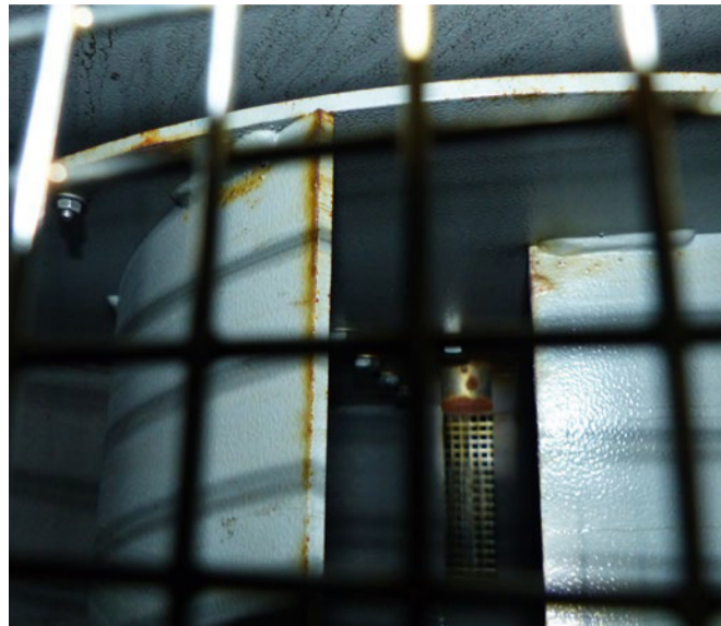
Montierter Ventilator mit Laufrad, hier beginnt die Korrosion am Kantenbereich bereits und ist erkennbar.
