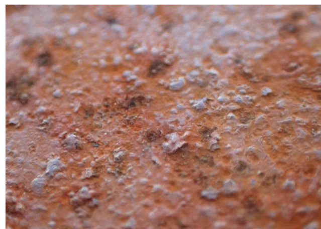
Die Stahloberfläche weist deutlich Korrosion mit erkennbaren Salzablagerungen auf.
