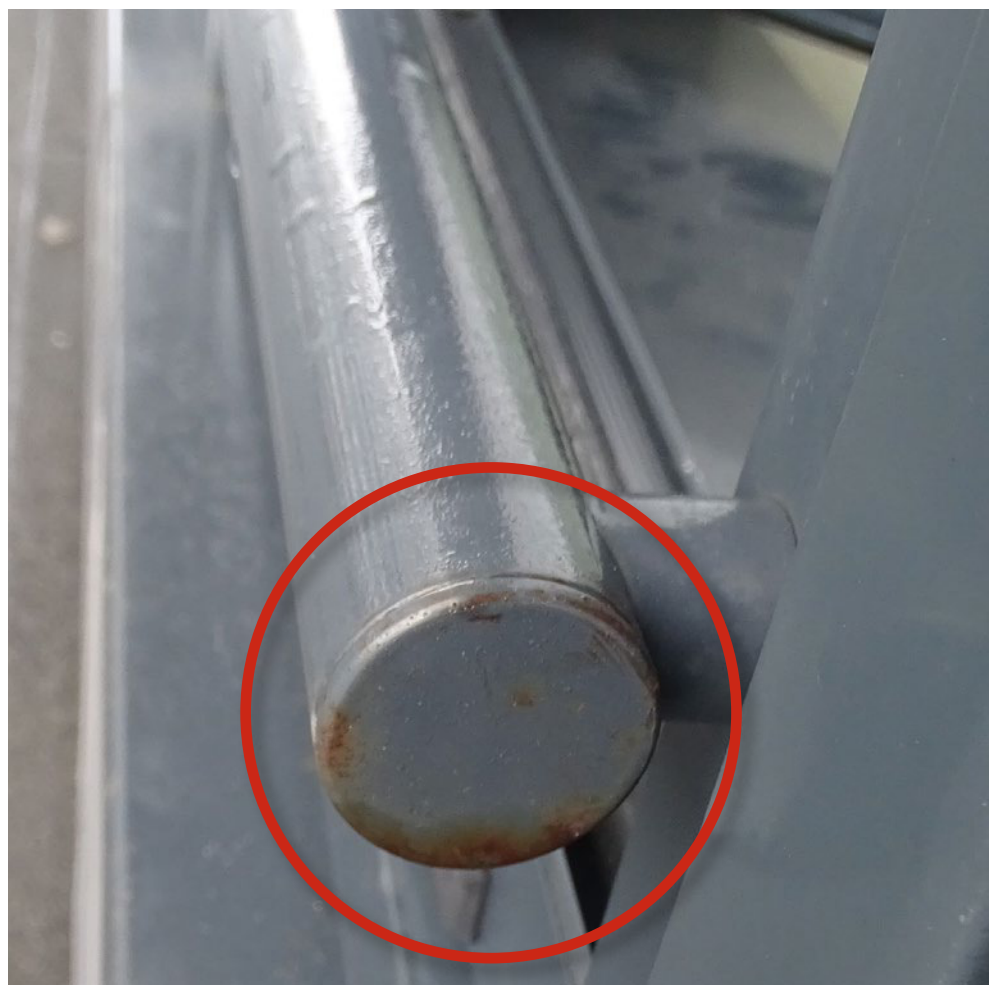
Die Absturzsicherung an einem Fenster in Meeresnähe weist sichtbaren Rotrost an der Endkappe auf.
