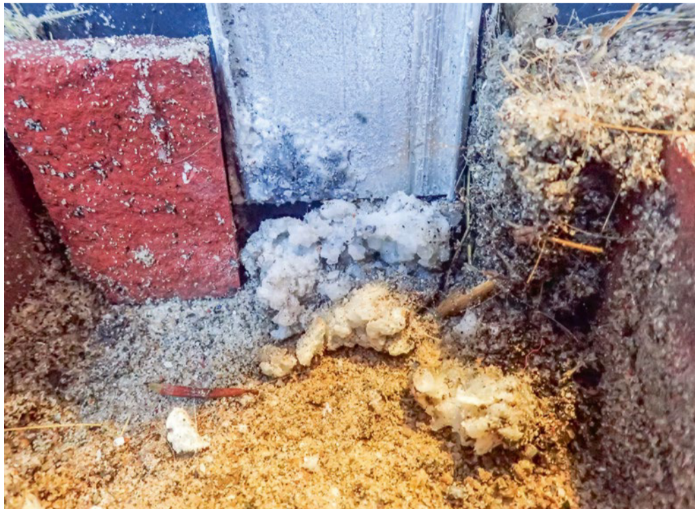
Beim nicht beschichtetem Halterungsprofil zersetzt sich das Aluminium.
