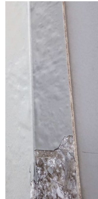
Der Lackfilm löst sich auf dem Aluminiumbauteil ab, darunter befindet sich Weißrost.
