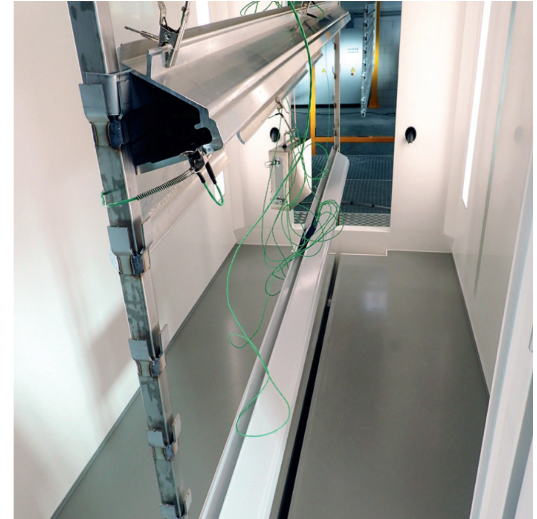
Beschichter sollten den Einbrennofen regelmäßig mit einer Ofenmessung überprüfen. Bei diesen Aluminiumprofil sind Messfühler für die Überprüfung des Einbrennofens installiert.
