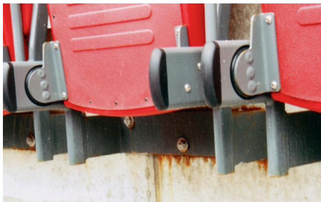
Die Sitze im Fußballstadion weisen Korrosion auf. Eine Eisenphosphatierung mit Pulverlack-Einfachbeschichtung ist bei nicht-verzinkten Stahlteilen ein ungenügender Korrosionsschutz.
