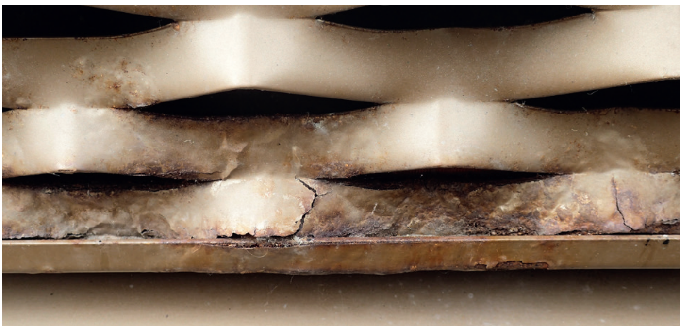
Diese Balkonverkleidung im Zentrum von München weist nach 1,5 Jahren deutliche Korrosionsschäden auf. Die Ursache liegt bei diesem einschichtig beschichtetem Bauteil in den zu geringen Schichtdicken auf den Kantenbereichen.
