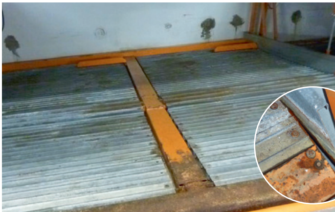
Der Doppelparkplatz in Mischbauweise ist eine einfach pulverlackierte Schwarzstahl-Rahmenkonstruktion mit aufliegenden Zinkblechen. Die Korrosion der Auffahrbereiche ist deutlich erkennbar und eine Folge der Ablagerungen von Auftausalzen mit ständiger Feuchte. Dadurch ist die Tragkraft und die Sicherheit bei Befahrung nicht mehr gewährleistet.
