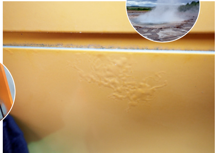
Die Gebäudefassade aus Aluminium auf Island weist Filiformkorrosion auf. Der Schadensfall resultiert aus ungenauen Vorgaben des Standortes bei der Bestellung beim Lackierbetrieb.
