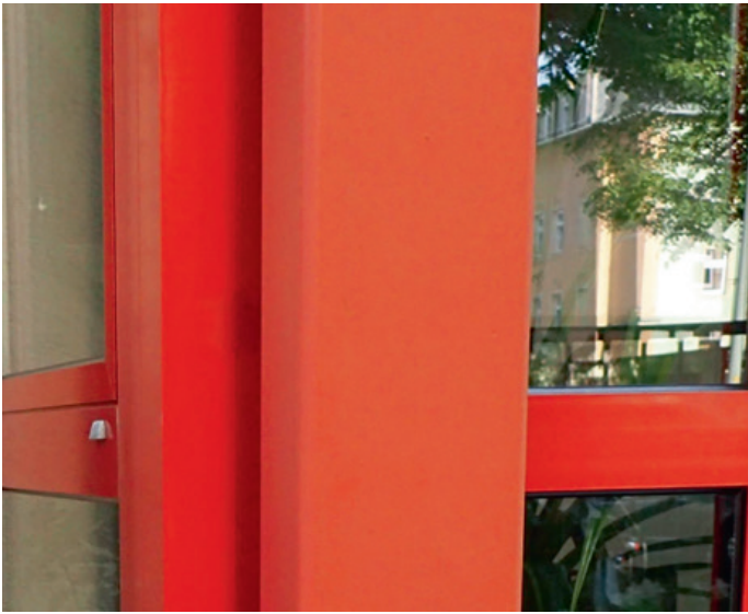
Das pulverbeschichtete Fassadenelement weist deutliche Farbton-Veränderungen durch UV-Beanspruchung auf. Fotos: Dr. Herrmann GmbH
