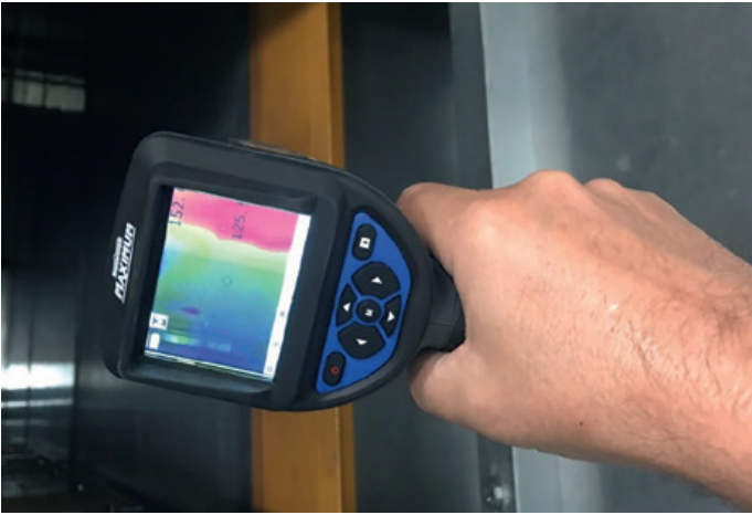
Das Wärmebild zeigt Kältebrücken an, d.h. zu niedrige Temperaturen im unteren Bereich des Ofenausgangs.
