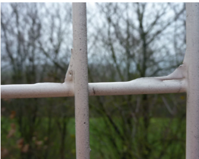
Nahaufnahmen der verzinkten und pulverlackierten Gittersegmente mit deutlich erkennbaren Störungen im Lackfilm aufgrund von nicht ordnungsgemäßem Grob-/Feinputz sowie scharfkantigen Rückständen/Abläufern nach der Verzinkung.
