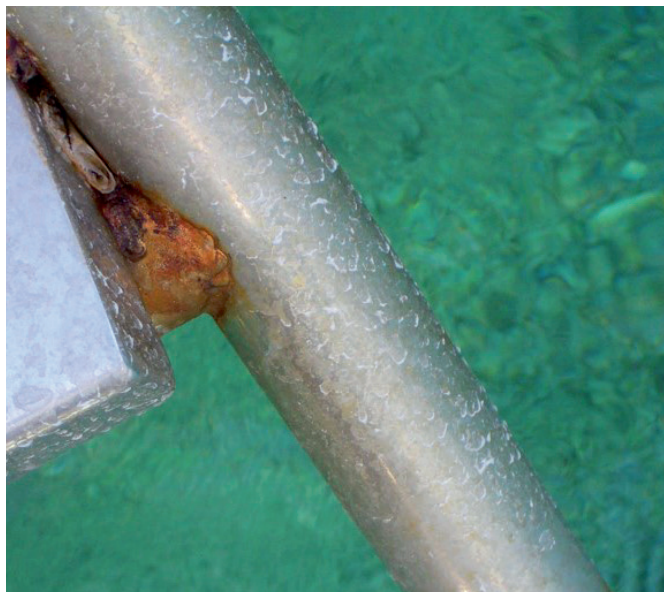
Wenn Edelstahl mit einer unedler legierten Elektrode geschweißt wird, kann es zu verstärkter Korrosion kommen, wie bei diesem Badepodest mit angeschweißter Edelstahl-Trittlfläche am Meer.
