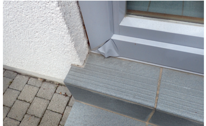
Die Pulverlackablösung am Gehrbereich durch ungenügende Lackfilmhaftung ist die Folge einer nicht ausgebildeter Konversionsschicht an diesen Aluminium-Klipp-Profilen. Fotos: Dr. Herrmann GmbH
